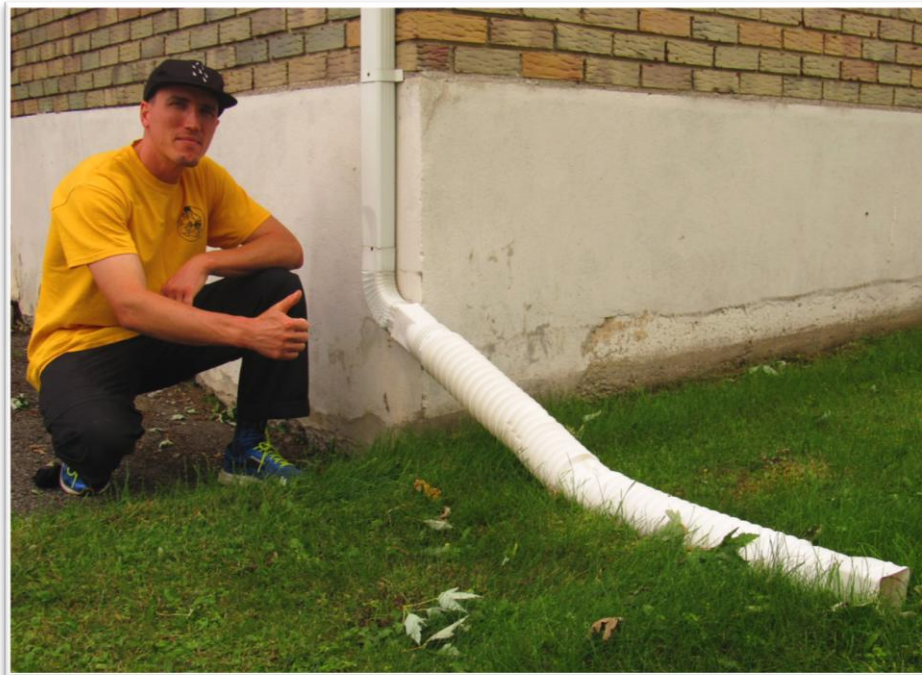
Image : l'employé de l'OBVBM Émile Veilleux devant une gouttière conforme de plus de 1,5 mètre laissant l'eau s'écouler sur une surface perméable (source : OBVBM)
